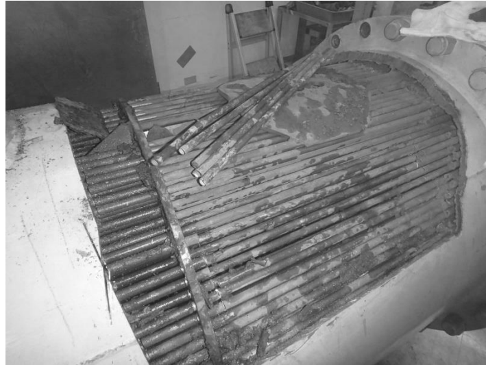
図 4.4.2-1 熱交換器（JRR-3）の内部
